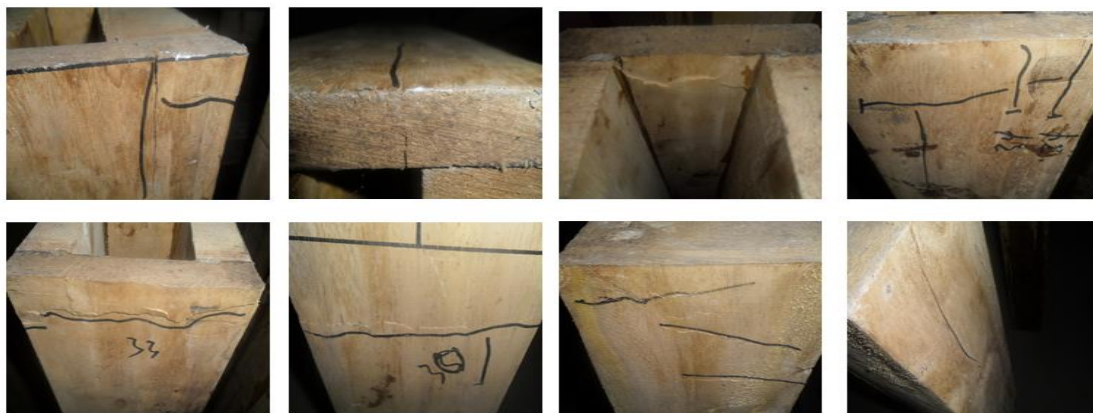
Gambar 17. Keruntuhan kolom kayu hollow dan kolom kayu solid
