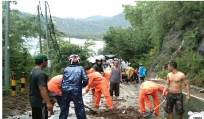
c. Longsor Desa Malaka Kec. Pemenang Lombok Utara (16 Oktober 2022)
