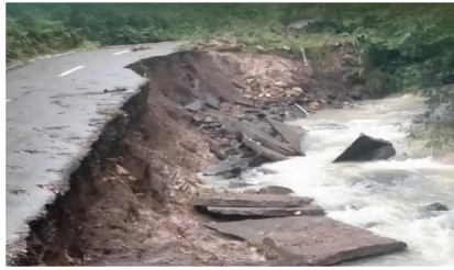
a. Longsor di wilayah Senggigi Lombok Barat (11 Januari 2022)
